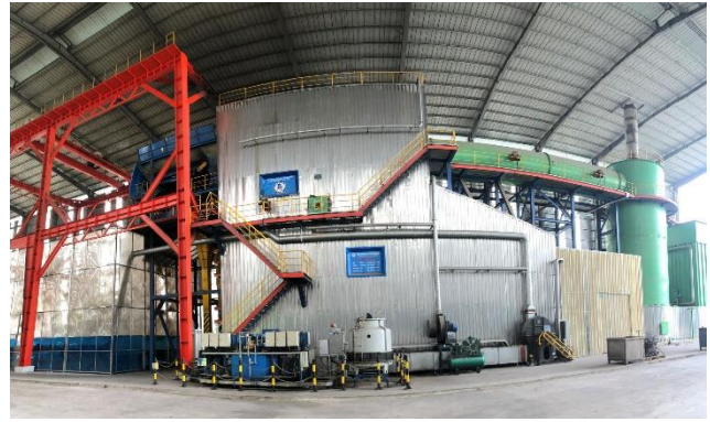
Lò đốt rác 200 tấn/giờ do công ty thiết kế thi công với mục tiêu kép vừa đốt rác công nghiệp, sinh hoạt vừa phát điện
